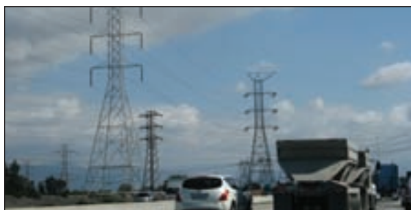
▲ شکل ۱-۵- انتقال انرژی الکتریکی توسط دکل‌ها
